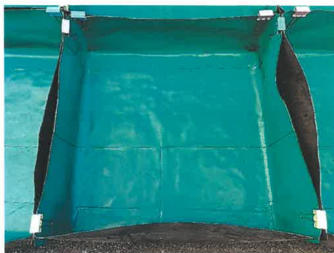
5 号试验箱 T 型缝及阴角图片
