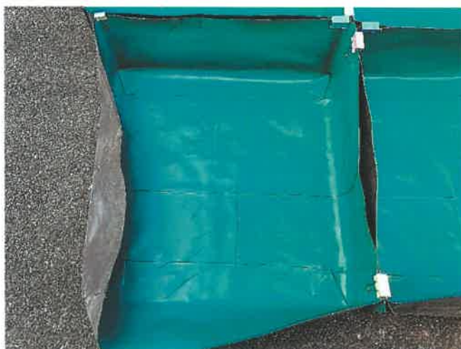
4 号试验箱 T 型缝及阴角图片
